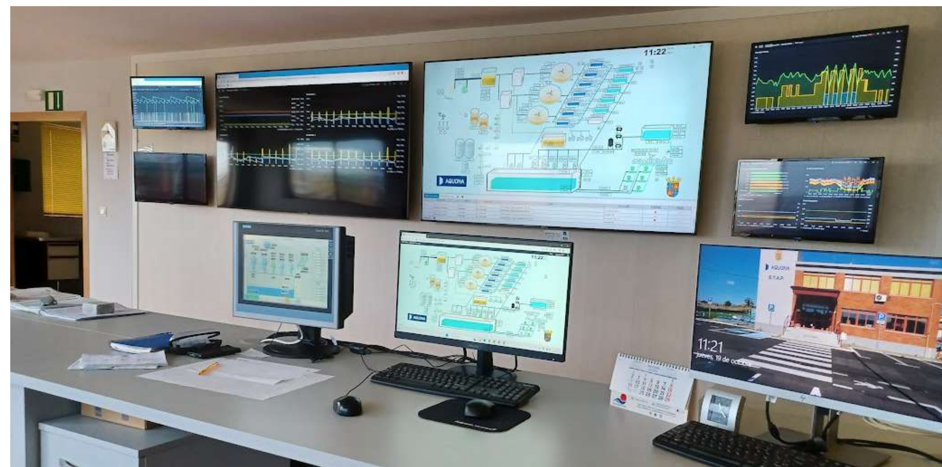
Sala de control en la ETAP de Palencia
