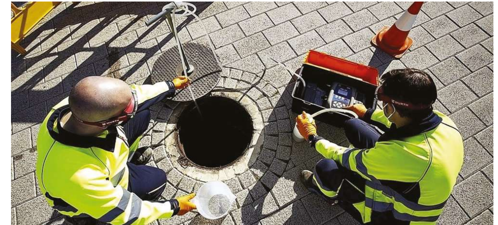
Cámara de inspección de la red de alcantarillado
